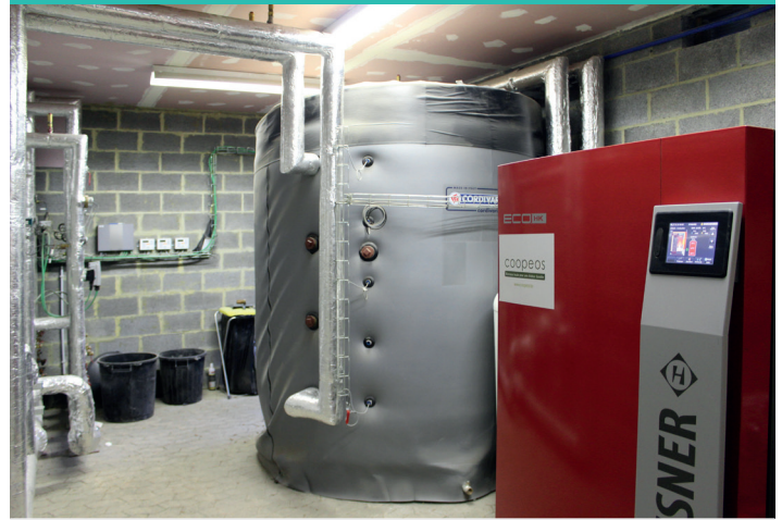
Le réseau de chaleur est alimenté par une chaufferie centralisée au bois. Cette solution nécessite de nombreux équipements périphériques, tels qu'un silo à bois, un extracteur, un ballon tampon, etc.
