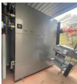
La nouvelle chaudière à plaquettes de bois. © L.M.
